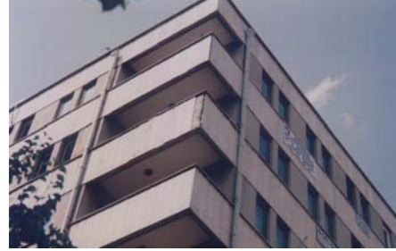
Şekil 8. İş merkezi cephesinden düşen kaplama.
