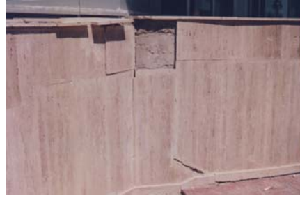
řekil 4. Duvarlarda har ile yapıřtırılan plak kaplamalar dūřmektedir.
