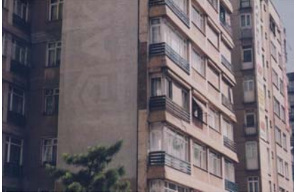
Şekil 7. Cepheden düşen doğal taş kaplama.
